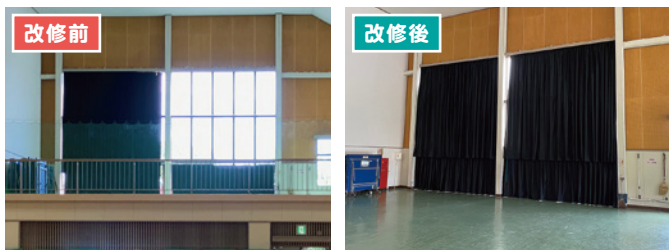
9月 越路体育館カーテン破損対応
